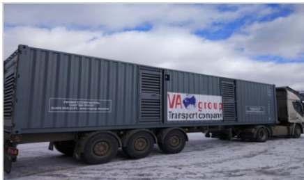
Дизель-генераторная установка на базе контейнера
